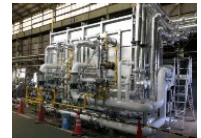
DINCS試験炉（滝春テクノセンター内）
